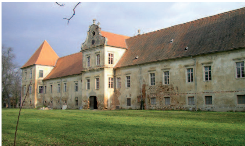
Salze zerstören, sie werden durch Mauerfeuchte transportiert.
