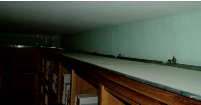
Ableitbleche auf den Archivregalen im Torhaus Dom zu Zeitz © IBB Ingenieurbüro Bautechnischer Brandschutz
