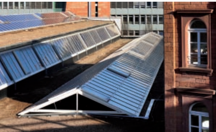
PV-Anlage auf dem Dach des Museums für Antike Schifffahrt, Mainz (Foto: René Müller, Römisch-Germanisches Zentralmuseum Mainz)
