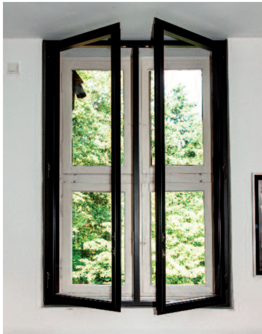
Diebstahlsichere Fenster trotz Denkmalschutz? In der Burg Vischering wurde diese Sicherheitslücke mit unauffälligen, maßgeschneiderten Zusatzfenstern geschlossen.
