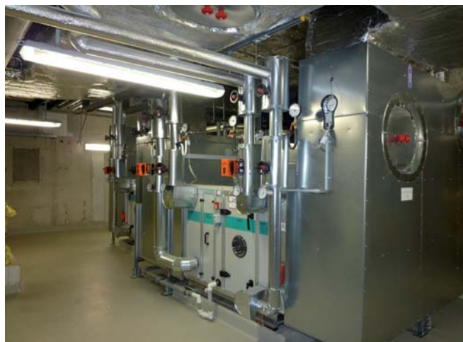
Blick in die neue Klimazentrale
