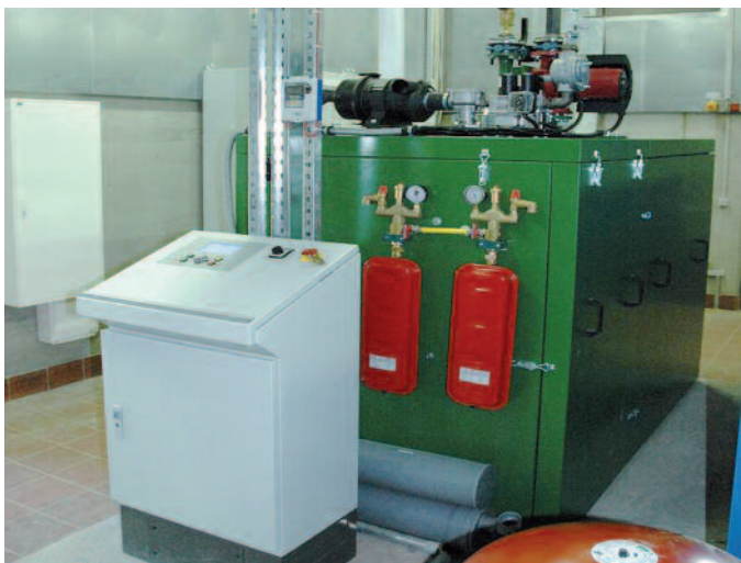
Mini-Blockheizkraftwerk; Copyright: Christian Grubert
