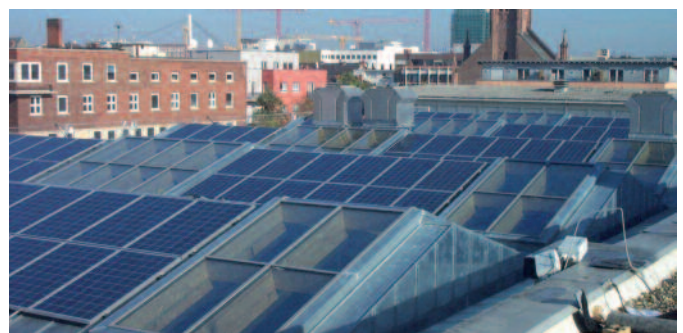
Photovoltaik-Anlage auf dem Dach
