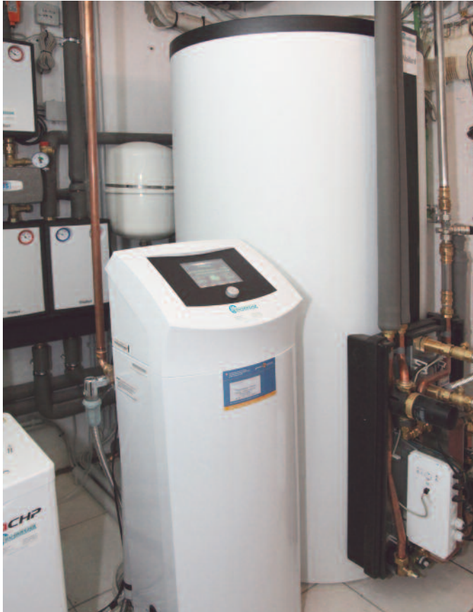
Mikro-BHKW, Foto: german contract gc Wärmedienste GmbH
