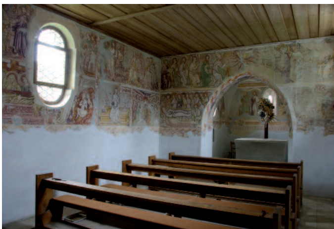
St. Bartholomäus, Hörgersdorf: Hl. Geist-Öffnung speziell umgebaut für Zuluftführung.
